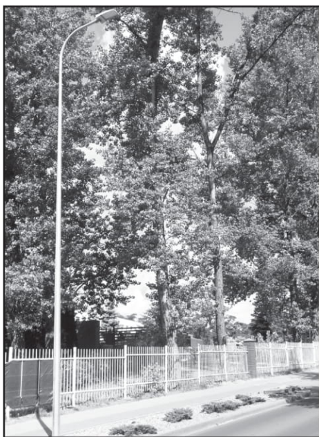
Rozbudowa oświetlenia ulicznego w gminie pochłonęła łącznie 190.678,06 zł. Zdjęcie przedstawia nowe lampy ustawione przy ulicy Dworcowej w Boszkowie-Letnisku.
